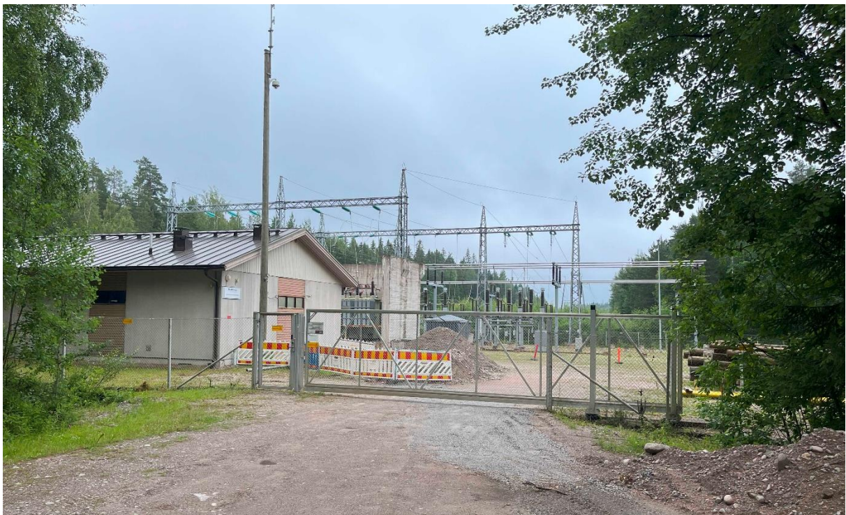
Kuva 9. Muuntamo kuvattuna etelään.
