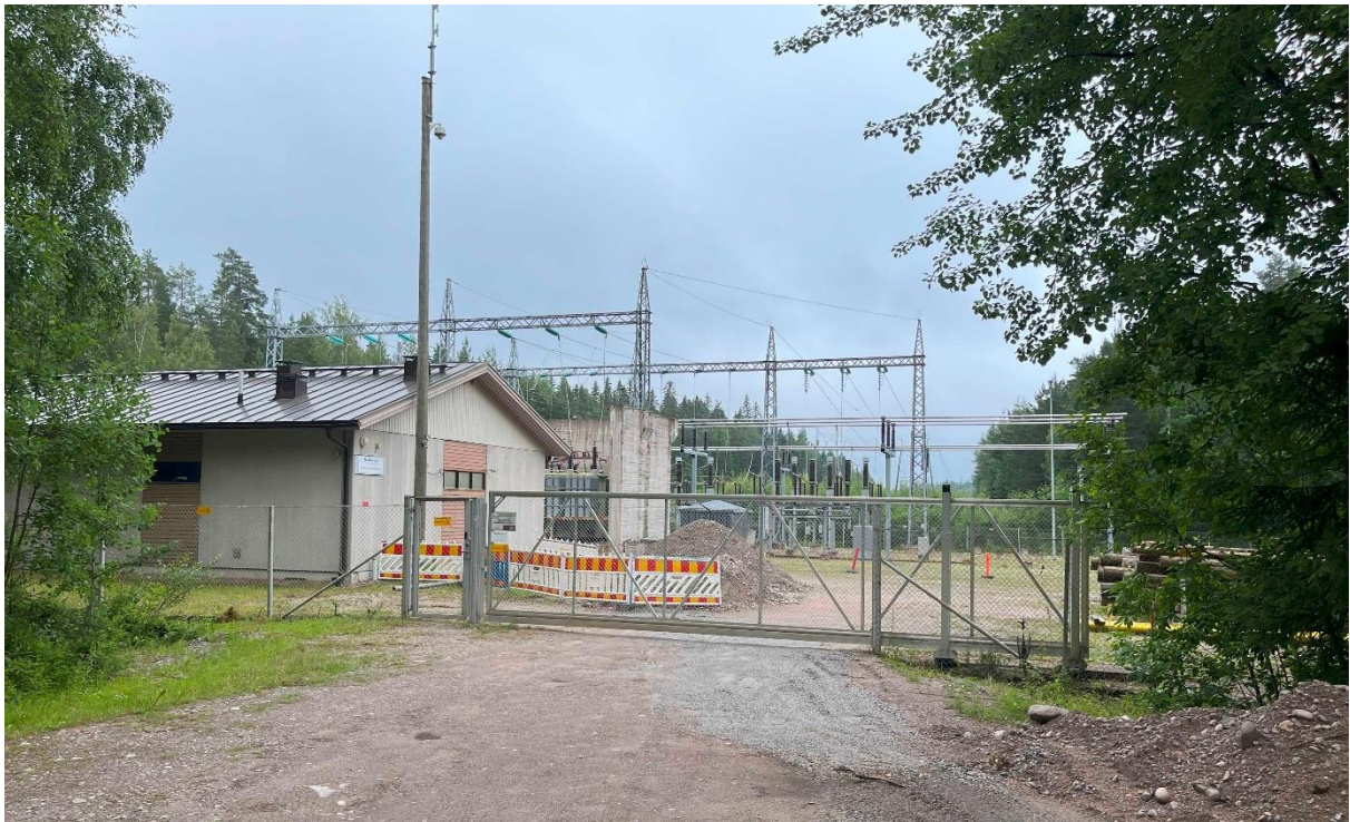
Kuva 9. Muuntamo kuvattuna etelään.
