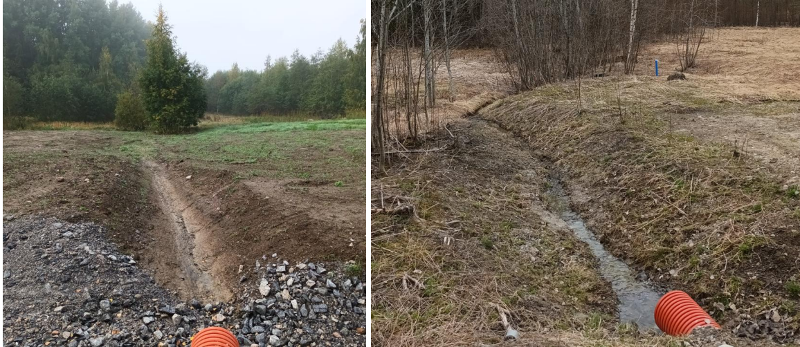
Kuva 11. ja 12. Vasemmalla Norolantien ali rakennettu 450 mm muovirumpu ja purkuoja kohti etelää [Ramboll 16.9.2024], oikealla Norolantien hulevesiviemärin 315 mm purkuputki ja purkuoja kohti etelää. [Ramboll 17.4.2025]
