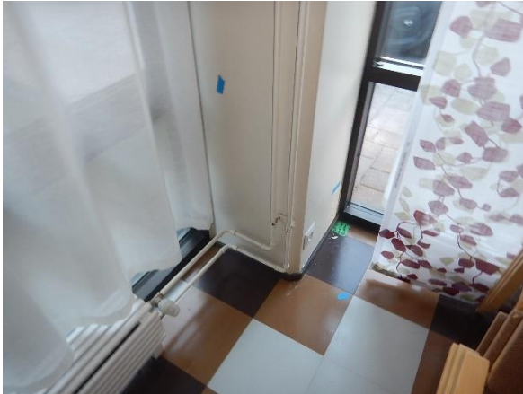
Kuva nro 7. Ruokalan lattiapinnotteessa mikrobivaurioita
