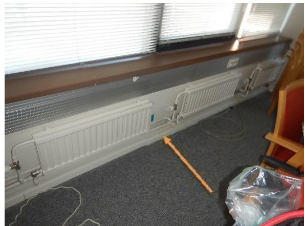
Kuva nro 16. Homekoira ilmaissut ulkoseinää
