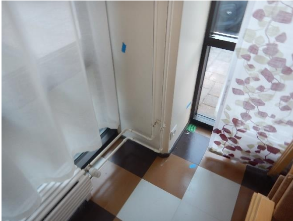
Kuva nro 7. Ruokalan lattiapinnotteessa mikrobivaurioita
