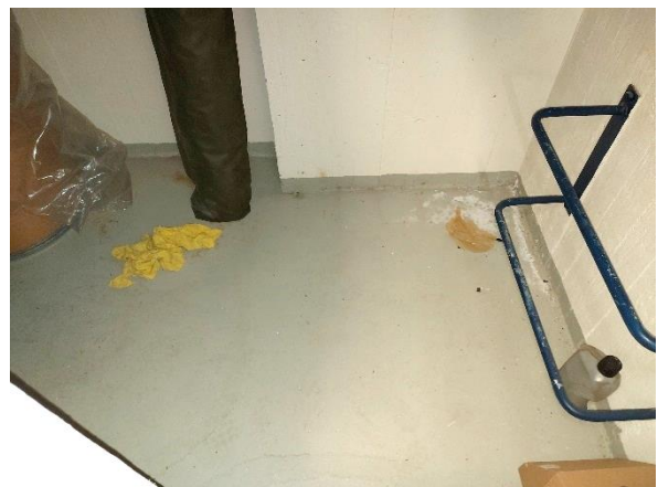
Kuva nro 12. VSS-tiloissa lattian maalipinta hilseilee
