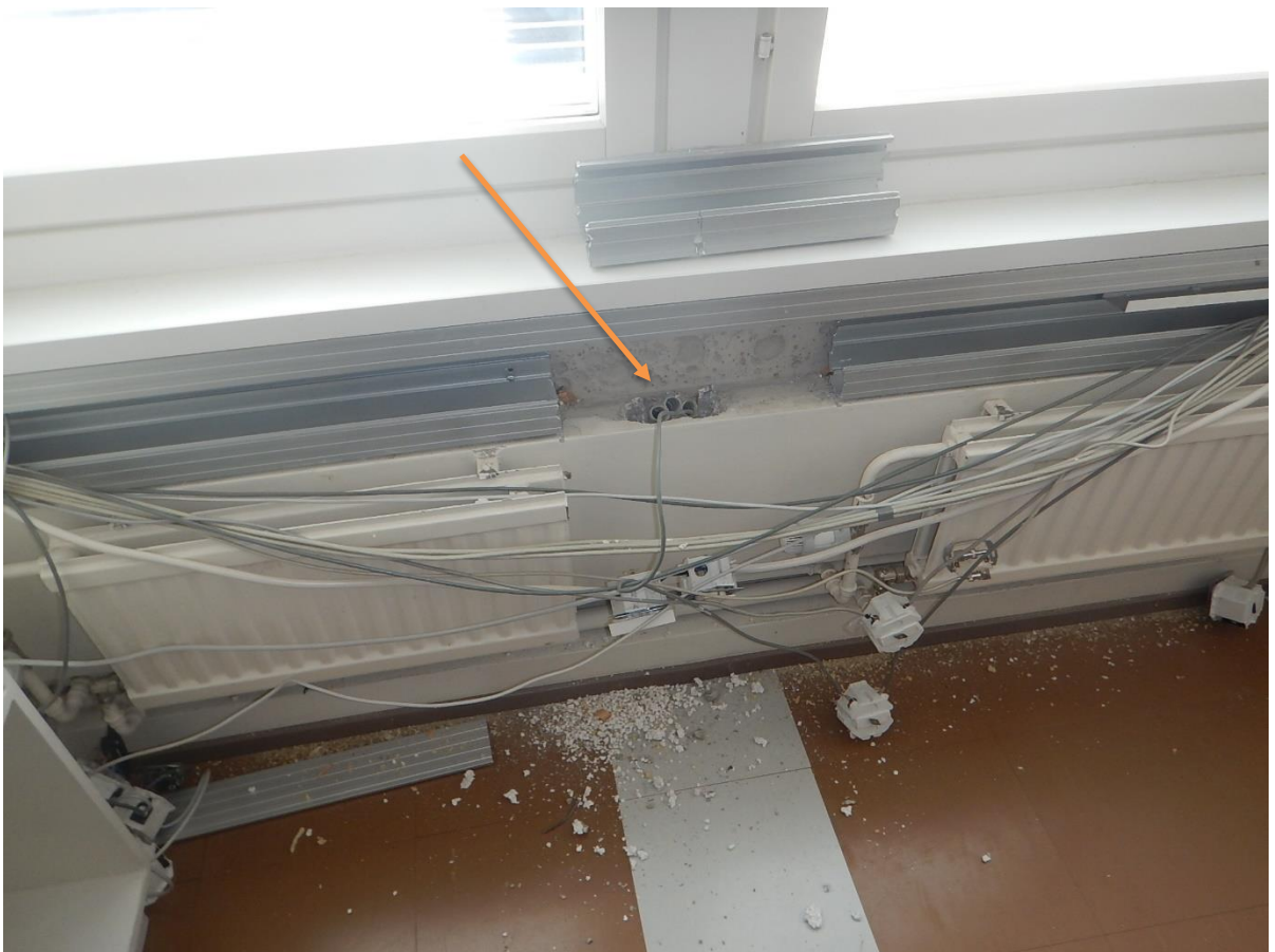
Kuva nro 4. Sähköjohtokourun takana on reiät ulkoseinäelementin sisään. Reikien kautta on ilmayhteys ulkoseinäelementin ja sisätilojen välillä.
