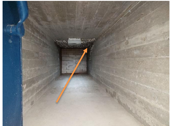
Kuva nro 10. VSS-tilojen hätäpoistumiskäytävä, kosteusjälkiä käytävän katossa ja seinissä
