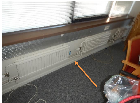
Kuva nro 16. Homekoira ilmaissut ulkoseinää
