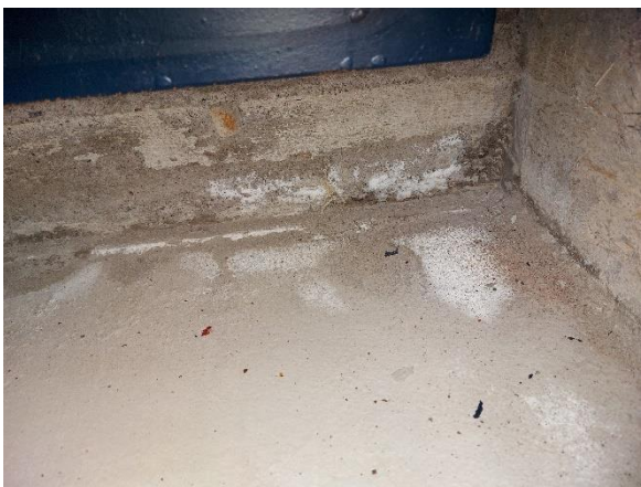
Kuva nro 11. VSS-tilojen hätäpoistumiskäytävässä kosteusjälkiä
