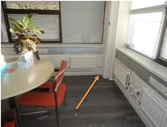
Kuva nro 15. Homekoira ilmaissut ulkonurkkaa
