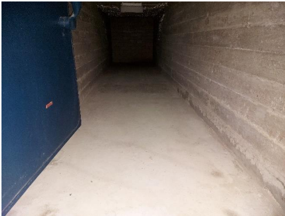
Kuva nro 9. VSS-tilojen hätäpoistumiskäytävä, tilassa tunkkainen haju
