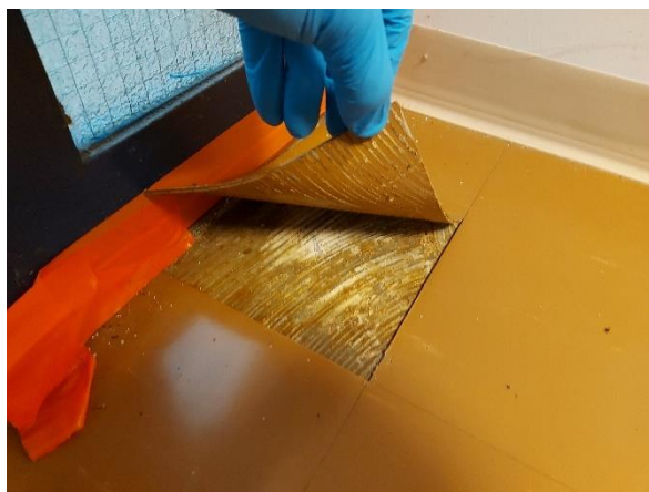
Kuva nro 5. Liima lattiapinnoitteen alla vaurioitunut
