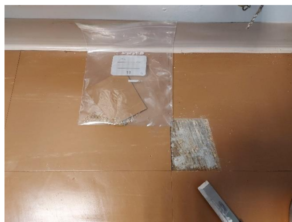
Kuva nro 6. Liima lattiapinnoitteen alla vaurioitunut
