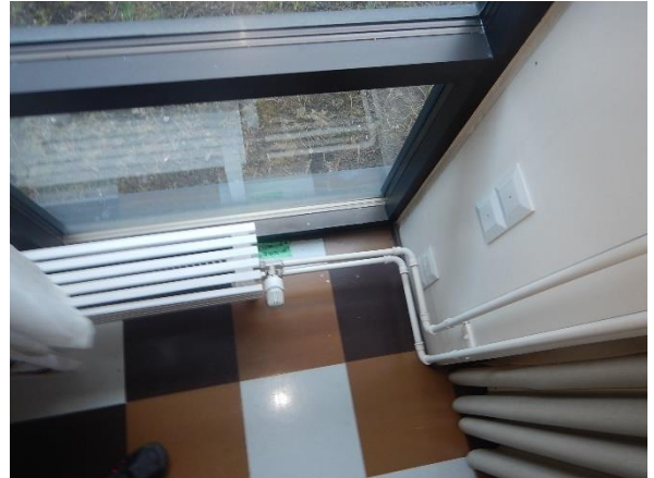
Kuva nro 8. Ruokalan lattiapinnotteessa mikrobivaurioita
