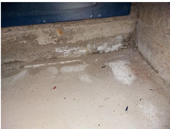
Kuva nro 11. VSS-tilojen hätäpoistumiskäytävässä kosteusjälkiä
