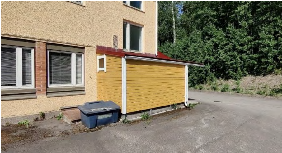
Kuva 76. Talo B, vuonna 1998 lisättiin puinen varastokatos ja mädallettiin keittiöikkunat. Punatillidetaljtit ovat alkuperäisiä.
