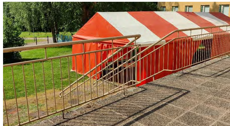
Kuva 90. Talo C, terassin pinnakaide ja päällysteet ovat oletettavasti vuodelta 1996. Portaat ovat vaurioituneet vuosien varrella.
