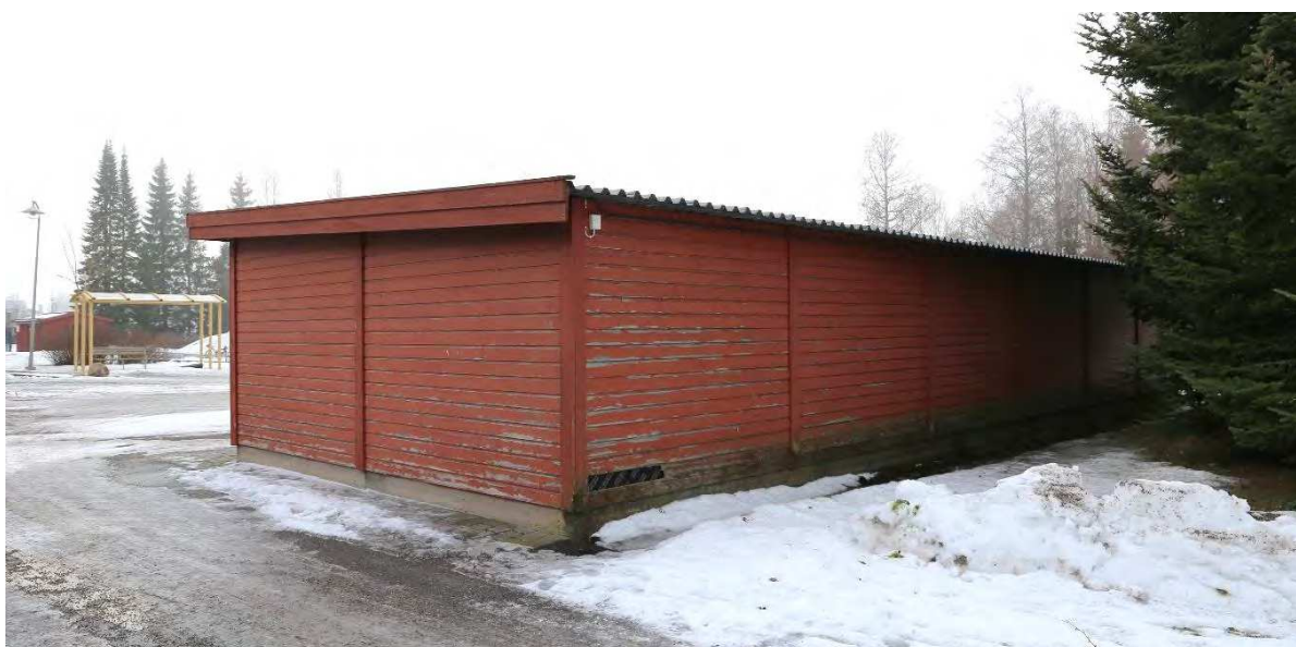
Kuva 130. Rakennuksessa ei ole ikkunoita.
