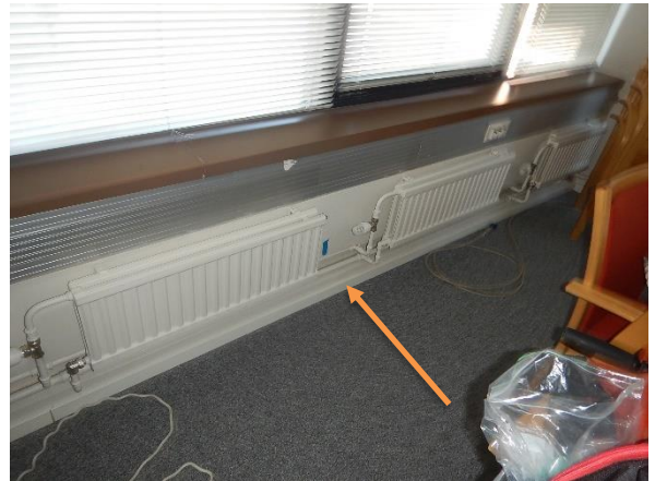
Kuva nro 16. Homekoira ilmaissut ulkoseinää
