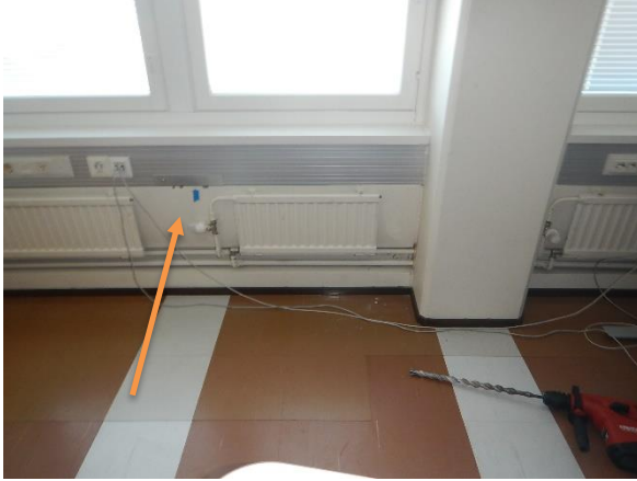
Kuva nro 13. Homekoira ilmaissut sähkökourua
