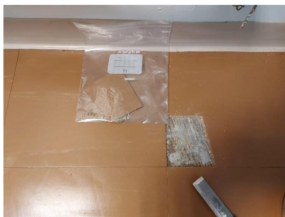
Kuva nro 6. Liima lattiapinnoitteen alla vaurioitunut
