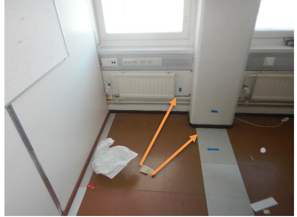
Kuva nro 14. Homekoira ilmaissut pilarin juurta ja ulkoseinää
