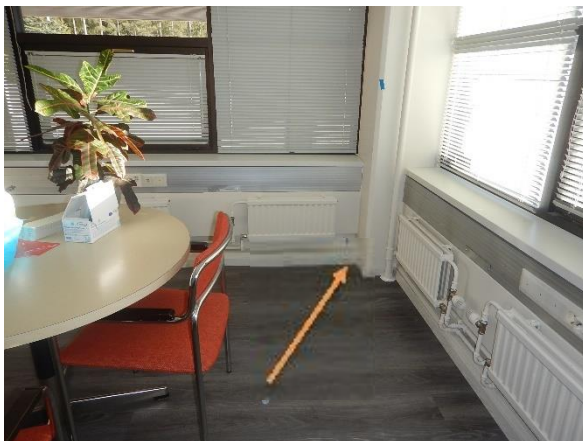
Kuva nro 15. Homekoira ilmaissut ulkonurkkaa
