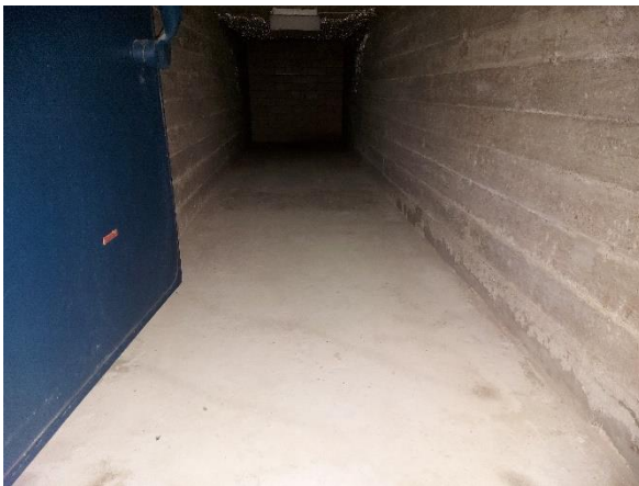
Kuva nro 9. VSS-tilojen hätäpoistumiskäytävä, tilassa tunkkainen haju
