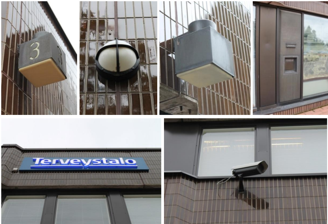
Valaisimia ja varusteita viraston julkisivuissa. Nelionmuotoiset valaisimet ovat alkuperäisiä tai alkupe- räistä vastaavia..
