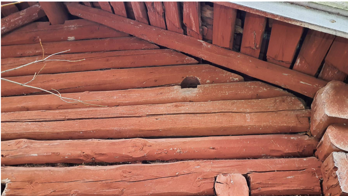
Kuva 10. Saunan seinässä oleva aukko on ainakin lintujen käytössä oleva reitti katon alle välitilaan, johon ei ole pääsyä rakenteita purkamatta.
