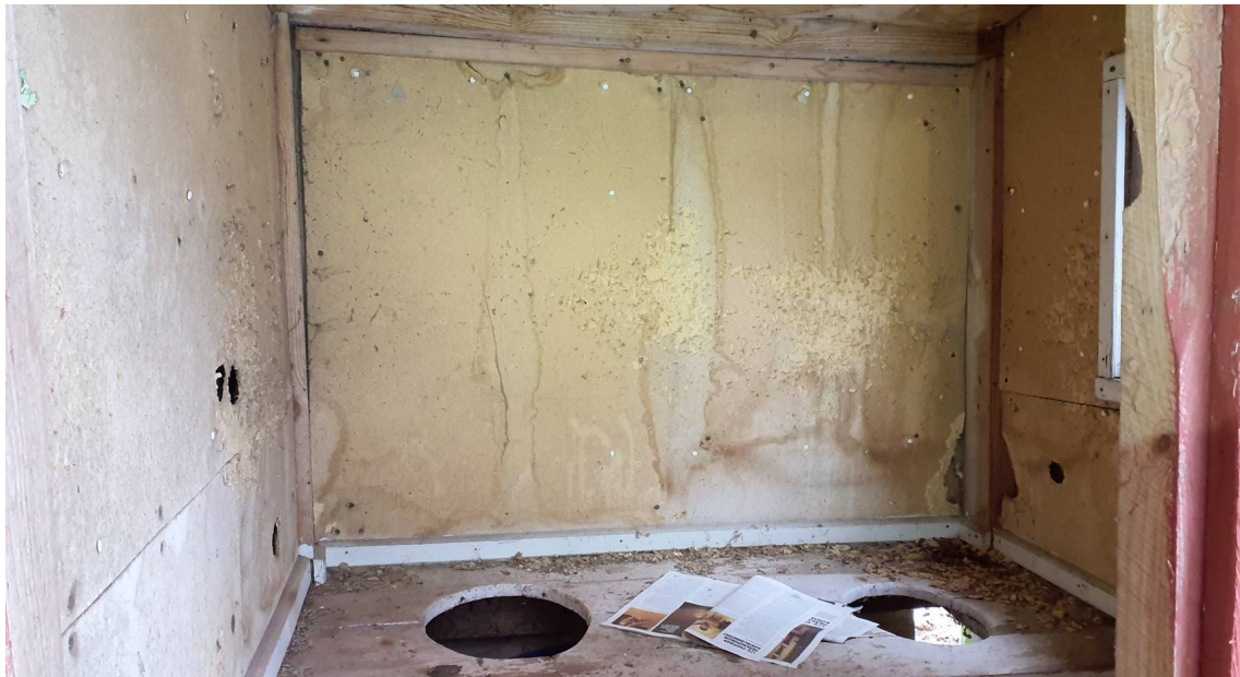
Kuva 7. Liiterin ulkokäymälän seinissä on mahdollisesti oravien kulkuaukkoja.
