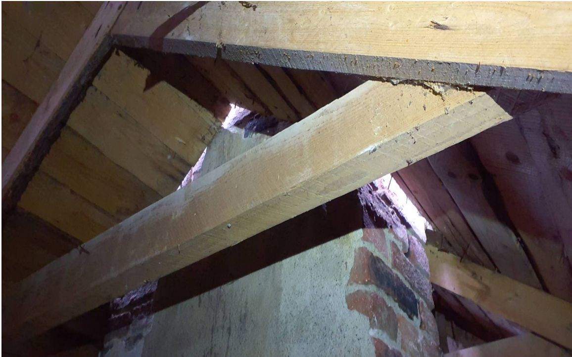
Kuva 3. Savupiipun ja katon välissä on 5–7 cm levyinen lepakkojen kulkureitiksi soveltuva rako, josta on esteetön pääsy ullakkotilaan.
