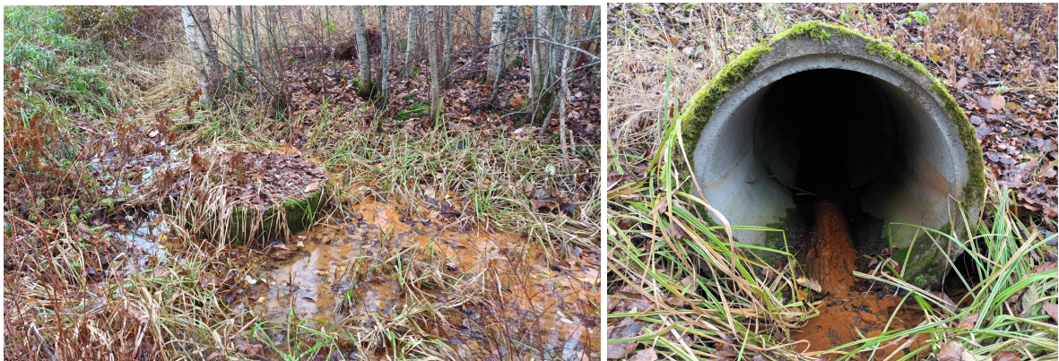
Kuvat 14 ja 15. Jarvalantien alittavan rummun yläjuoksulla on ojassa pienellä alueella rautasakkaa. [Ramboll 23.10.2025]
