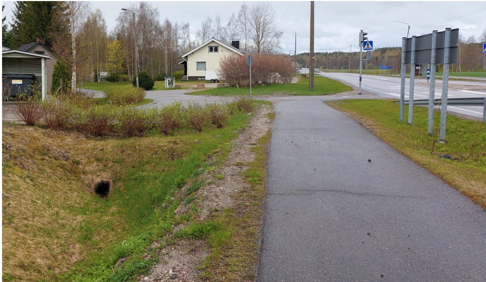
Kuva 13. Nykyinen 450/400 mm muovirumpu Pihtakuusenkujan suuntaan sekä jkpp-väylän alla tiealuelta tuleva nykyinen 250 mm muovirumpu. [Ramboll 14.5.2025]
